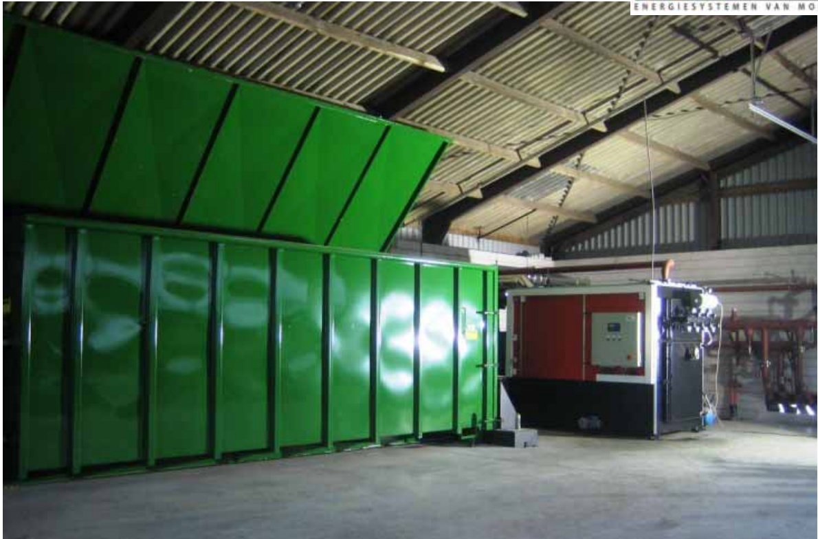
600 kW op houtsnippers: Verwarming van een pluimveebedrijf
