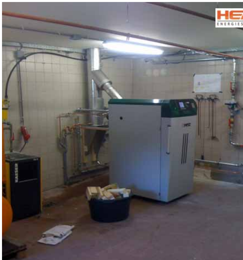
40 kW op stookhout: Verwarming van werkplaats en kantoor bij bouwbedrijf
