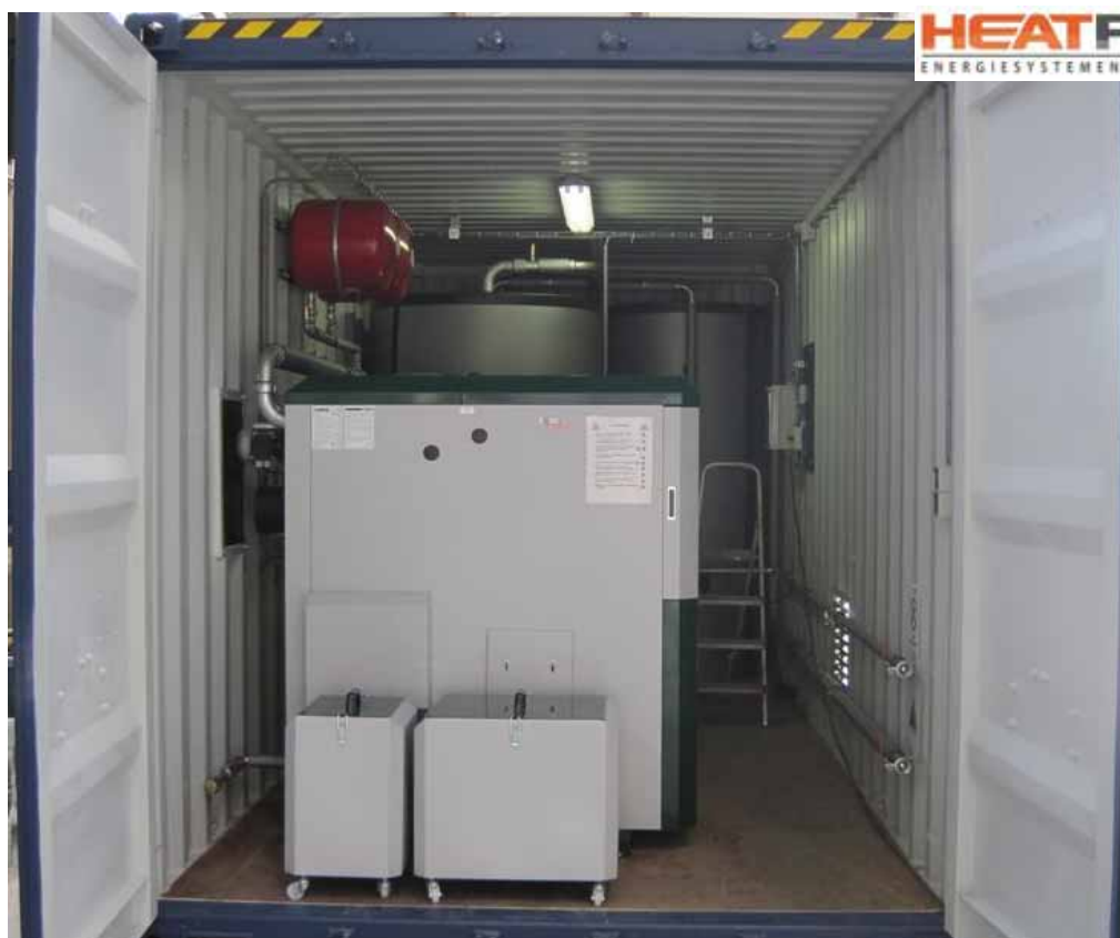
90 kW op houtsnippers compleet ingebouwd in 20ft container: Verwarming van werkplaats en kantoor bij een groen-aannemer
